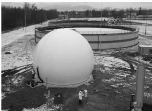
Rysunek 5. Zbiornik biogazu w oczyszczalni ścieków w Skoczowie
